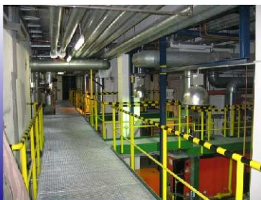
Bestehende Zentrale Versorgungsanlage (ZVA)
