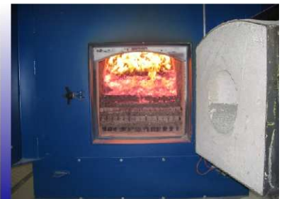
Blick in den Feuerraum, Nennleistung 900 kW
