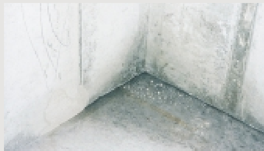
Bild 1.4 • Wasser im Keller
