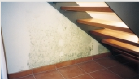
Bild 1.3 • Schimmel an den Wänden
